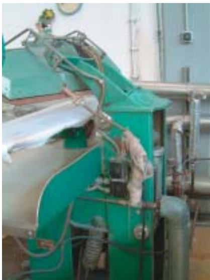
Abb. 2: Asbesthaltiges Isoliermaterial am Bügeltisch
