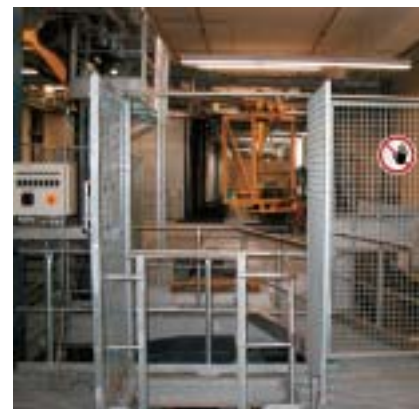
Vollautomatisches Hochregallager Zugangssperre, Not-Aus-Schalter
