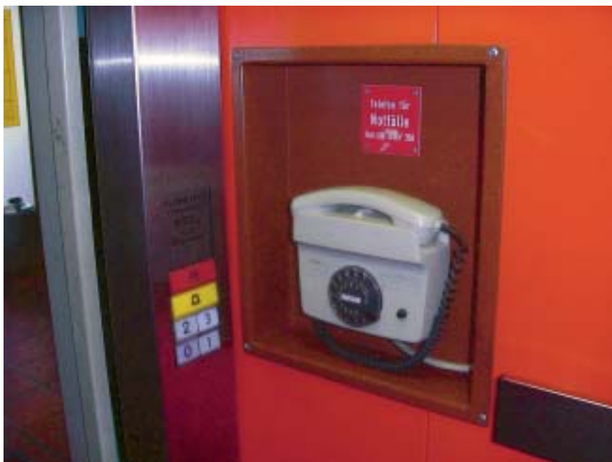
Notrufanlage in einem Fahrkorb
