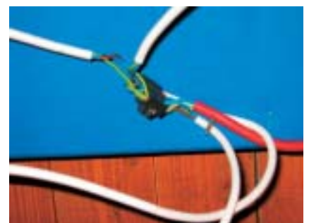
Abb. 1: unsachgemäße Verbindung von Stromkabeln
