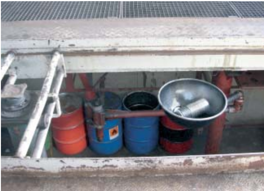
Bild 1: Beispiel einer unzulässigen Lagerung brennbarer Flüssigkeiten (Altöl) in der Arbeitsgrube (hier war auch der fehlende Deckel am Einfülltrichter zu beanstanden)
