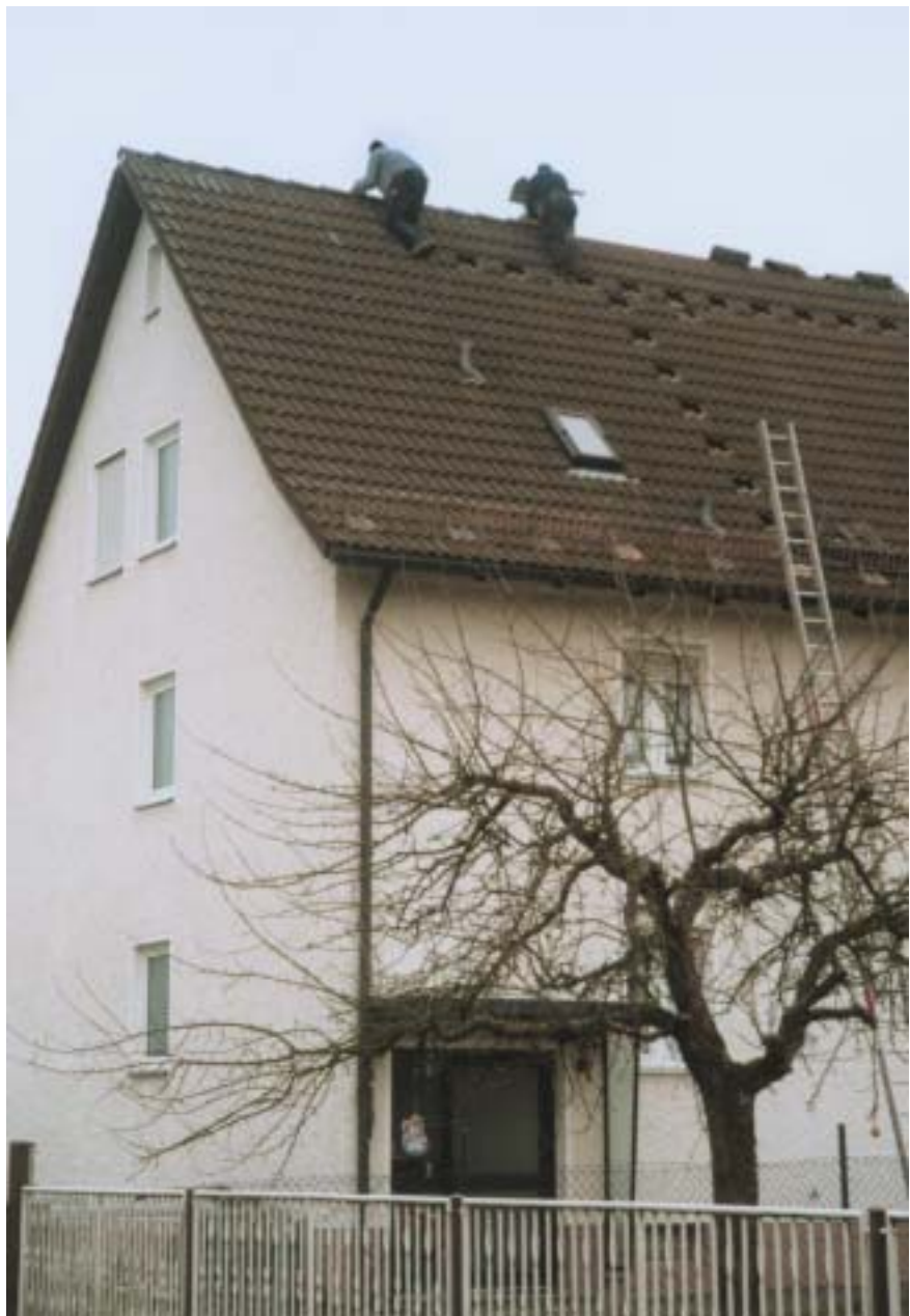
Abb. 6: Dacharbeiten ohne Schutzgerüst
