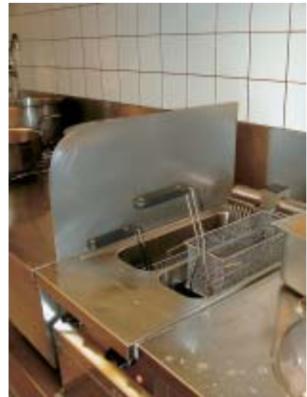
Abb. 3: Friteuse und Kippbratpfanne durch Spritzschutzeinrichtung (Abweisblech) getrennt
